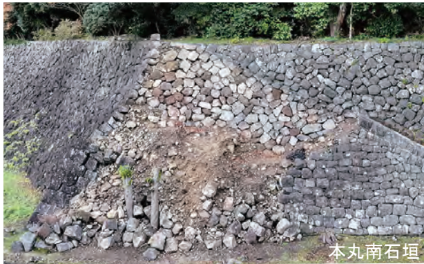
調査実施前の状況 旧陸軍が改築した高石垣に付加した石階段が崩落。石材回収と解体を実施した。
